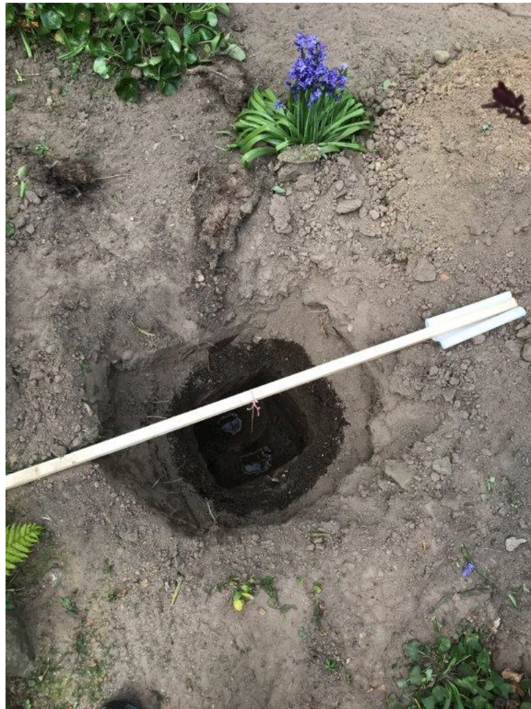
Figur 6 Testhul ved Bisgårdvej 27.
