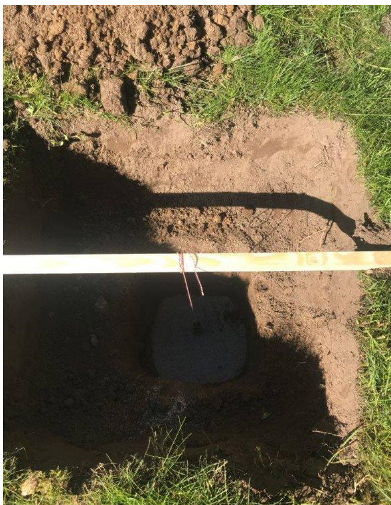
Figur 1 Testhul ved Bisgårdvej 1.
